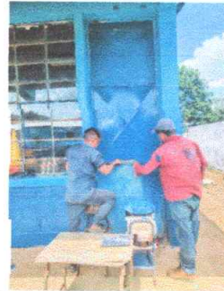
Foto 4: Pintada de la puerta del módulo 2
